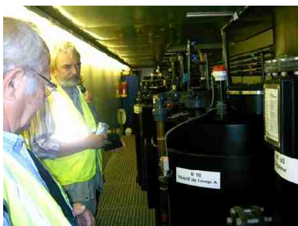
Photo 4 : station de traitement des lixiviats
